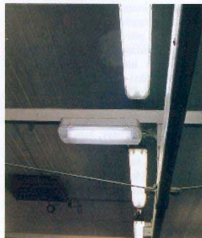
Poikittain oleva pieni varavalo palaa kauan sähkökatkon jälkeenkin.
