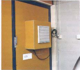
Jäähdytysilma puhalletaan tällä puhaltimella maitohuoneeseen, josta se lämmentenään virtaa...
