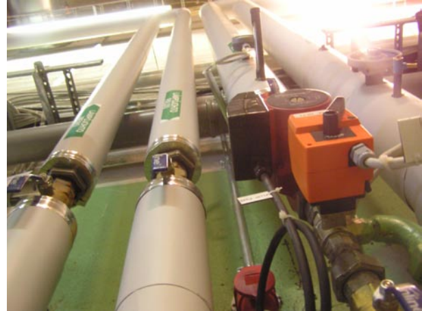
Oulun jätehuollon mikroturbiinilaitos, jossa kaatopaikan biokaasua jalostetaan sähköksi ja lämmöksi
