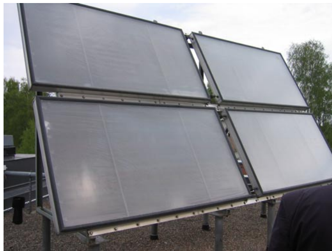
Uusiutuvan energian tuotannossa on lukuisia vaihtoehtoja suorasta aurinkoenergiasta lähtien. Eri tuotantotavat soveltuvat erilaisiin käyttökohteisiin.
